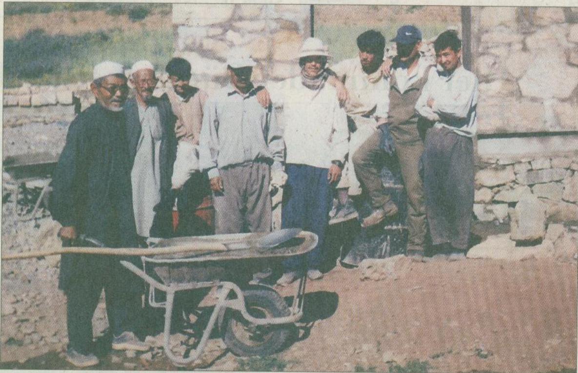
Ein kleines Gebäude als Hoffnungsträger für die gesamte Region: Dank der Hilfe auch von vielen Bad Homburgern kann in dem afghanischen Dorf Tarpas eine Frauenklinik gebaut werden.
